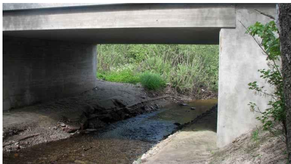
Figura 131. Obra de drenaje adaptada. Finlandia. Foto de: Milla Niemi (Yle, 2016).
