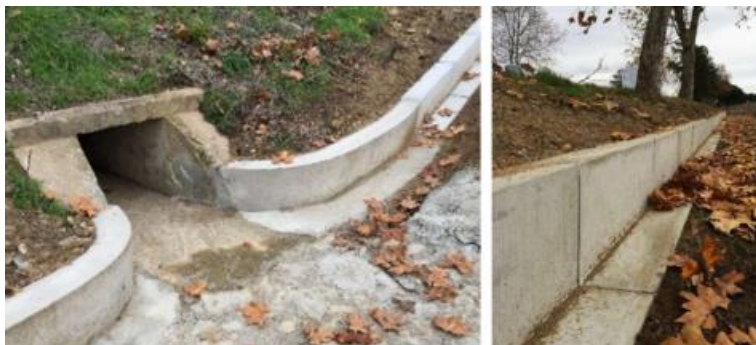
Figura 148. Pasos para anfibios. (Infraestruturas da Portugal (IP), 2024).
