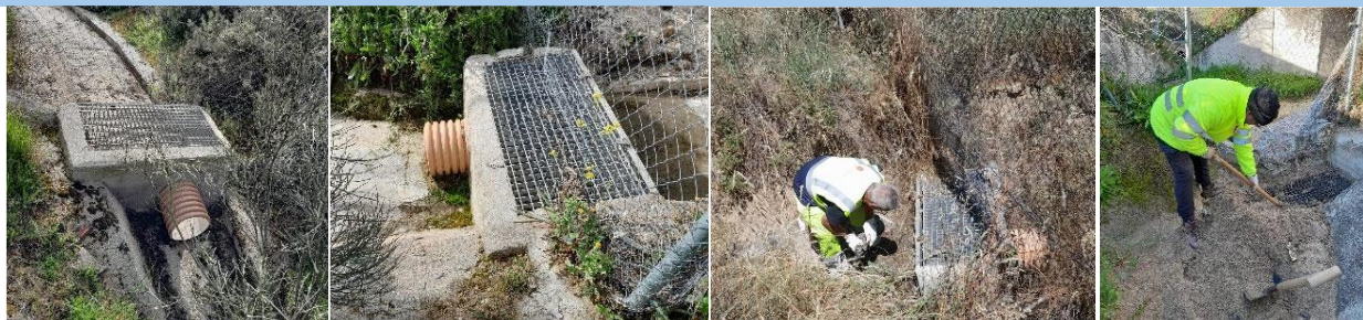
Figura 46. Arquetas en los puntos de intersección entre cerramiento y cunetas. (Comunidad de Madrid).
