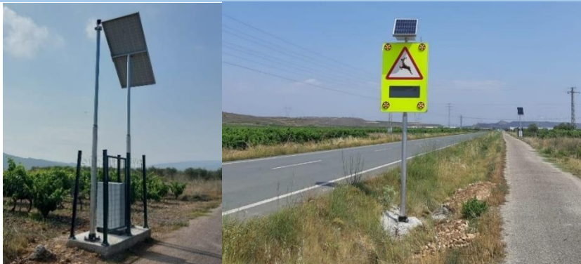
Figura 20. Señalización dinámica inteligente: detección mediante visión artificial. (Gobierno de La Rioja, 2023).
