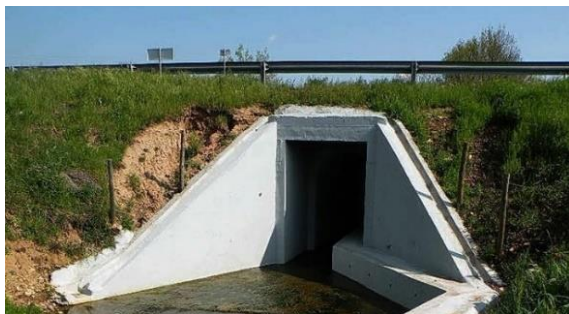
Figura 144. Obra de drenaje adaptada (Infraestructuras de Portugal (IP), s.f.).
