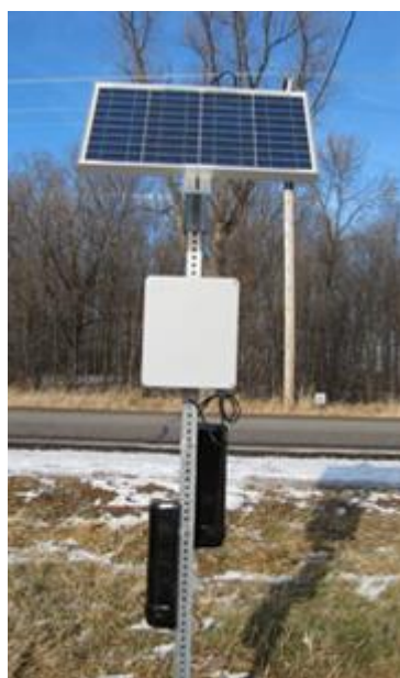
Figura 70. Sistema de detección y advertencia de ciervos a lo largo de la autopista 23 cerca de Marshall. Foto de Ken Hansen. (News for employees of the Minnesota Department of Transportation, 2012)
